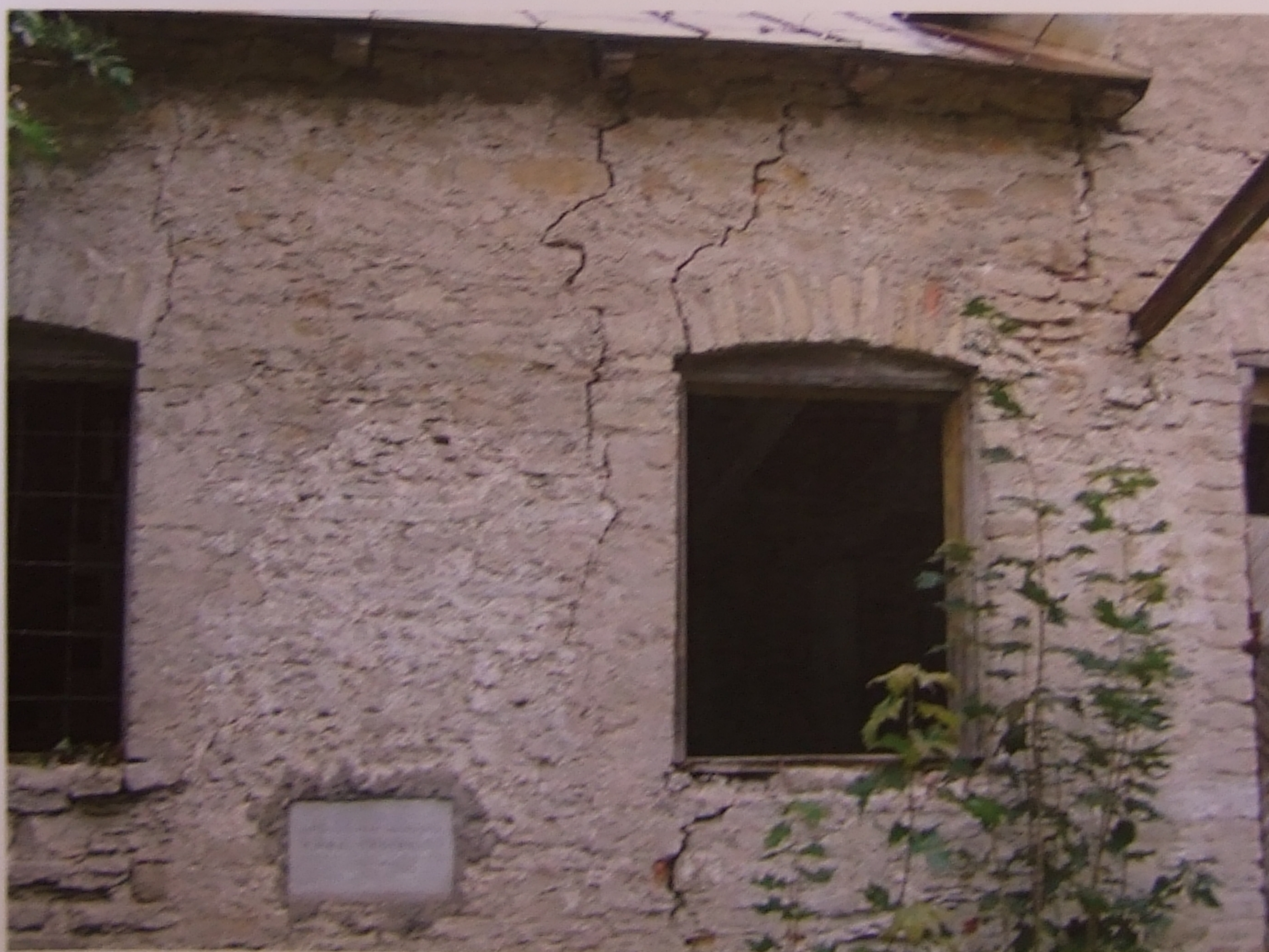
FOTO 2: Vesiveski esikülje vaade sillalt. Hoone on ümbritsetud suurte puudega. Puuduvad kõik aknad ja uksed.
