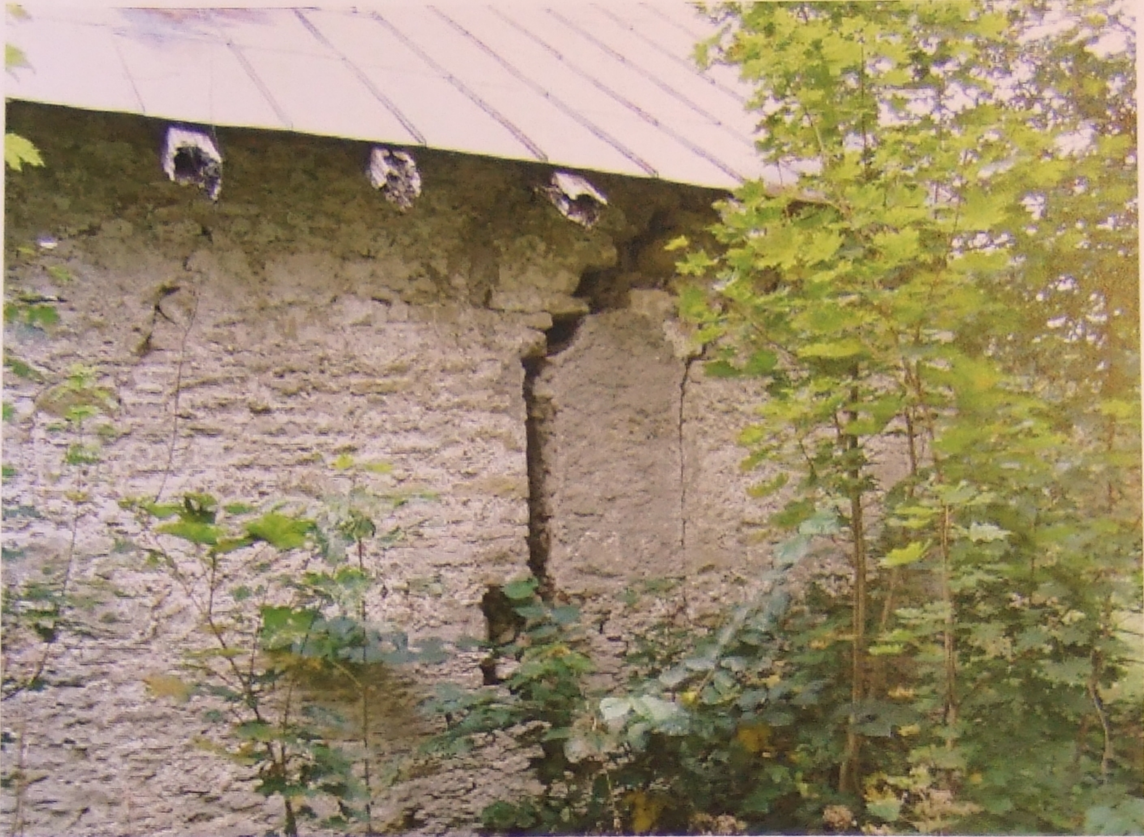
FOTO 5: Tagakülje jõepoolne ots. Näha on äärmiselt suured ja avariiohtlikud deformatsioonipraod.
