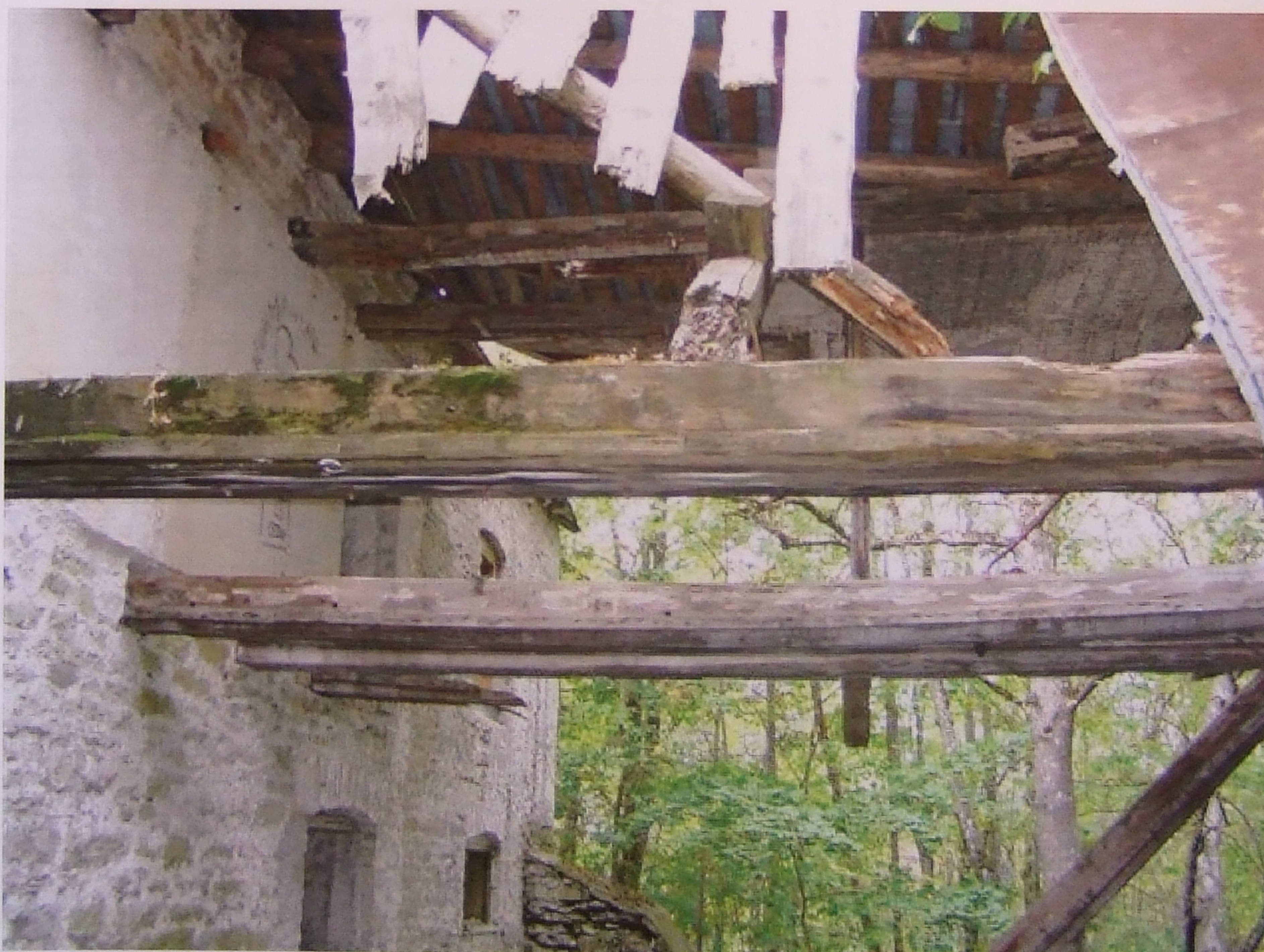
FOTO 8: Tagakülje juurdeehitus on väga suurte seenkahjustustega ning kõik puitkonstruktsioonid tuleb asendada uutega.
