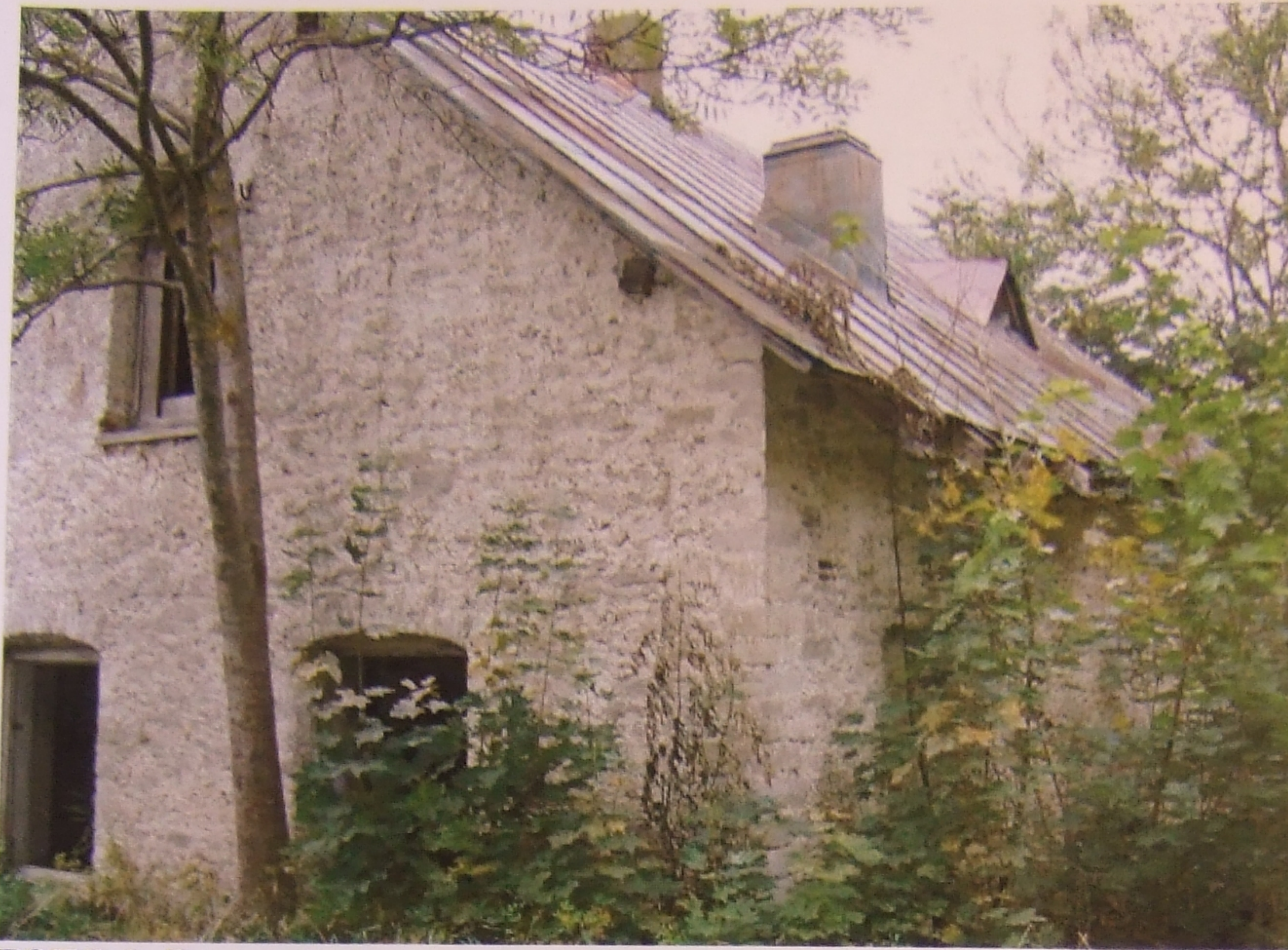
FOTO 3: Parempoolne otsasein ja tagakülg. Otsaseinas deformatsioone ei ole. Lähisümbrus on võsastunud.
