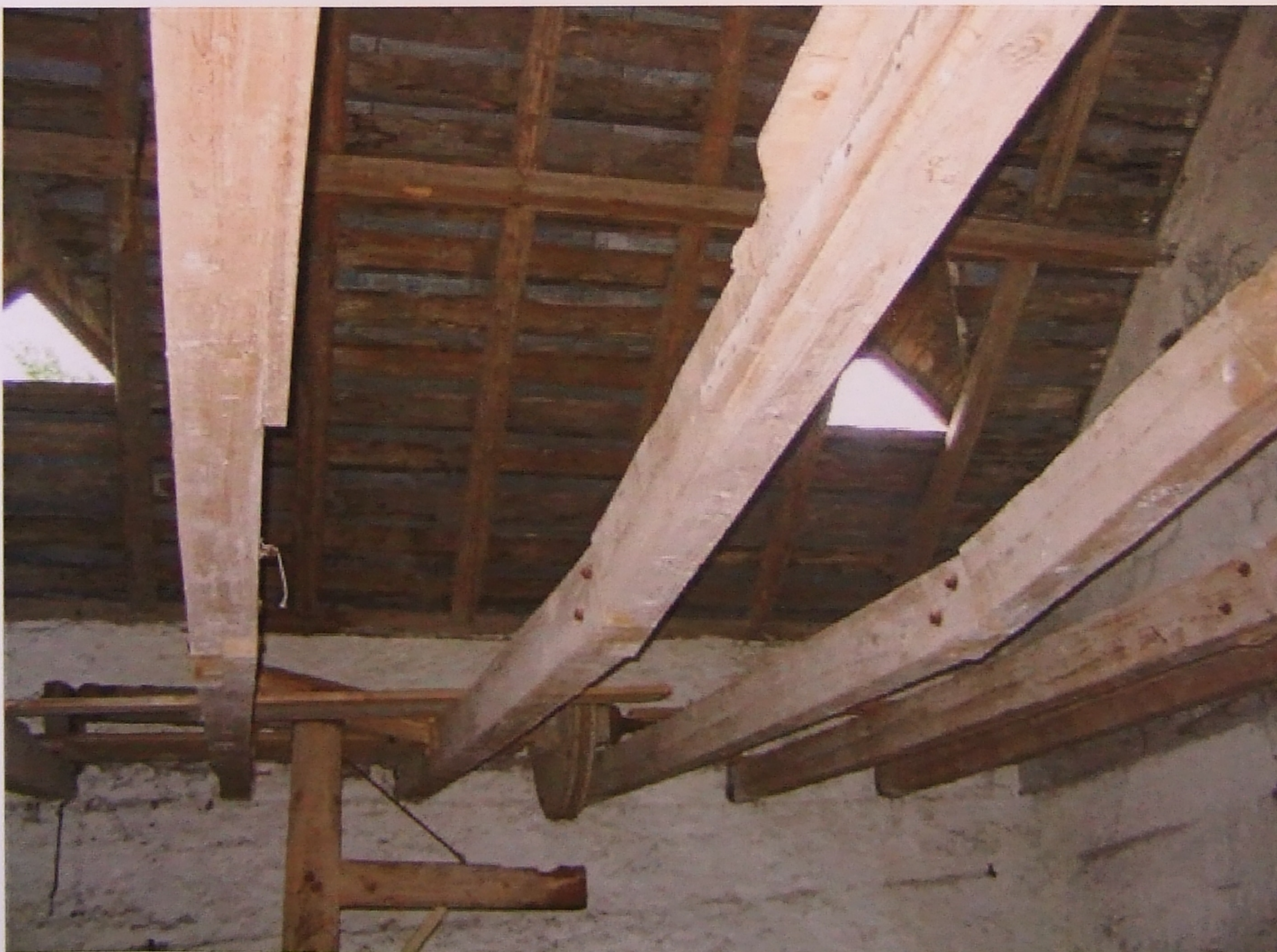
FOTO 6: Veski masinasaali pööningu vahelagi. Vahelae talade alt on eemaldatud tugistik ning talad on vajunud avariiohtlikult läbi jätkusõlme kohalt.
